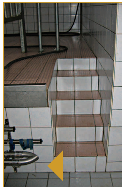
Tuyau de collecte aller-retour n'entravant pas l'accès à l'escalier
