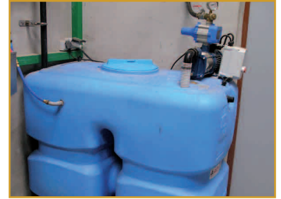
Cuve de stockage d'eau
