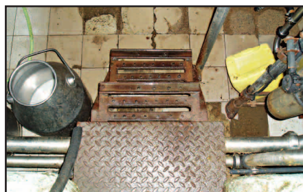
Carrelage dégradé en fosse de traite
