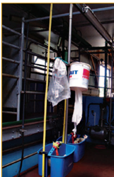
Système de porte-seaux à glissière et tuyaux de lavage suspendus
