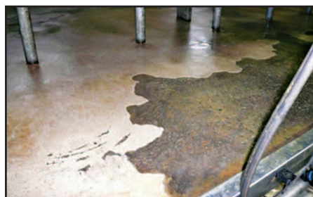
Résine sur quai qui se décolle
